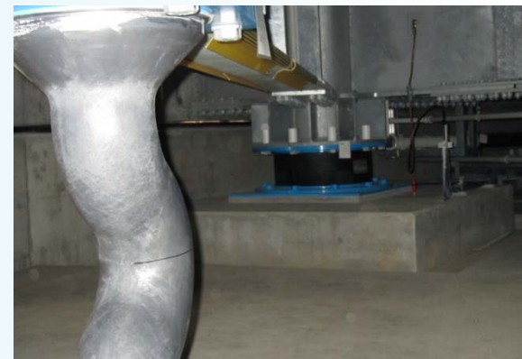
支援棟免震設備
