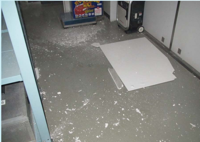
資機材庫にて、天井板一部破損
