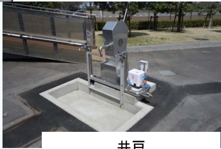
井戸 電動ポンプ/手押しポンプ 平成24年度末設置
